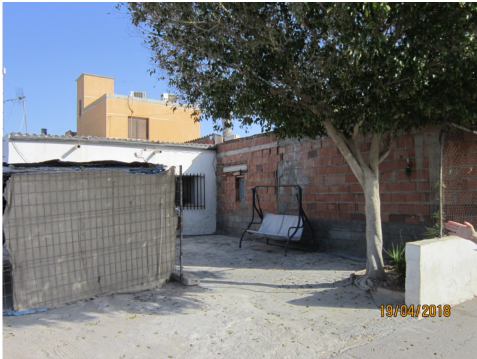
Viviendas inacabadas y con cubiertas deficientes en Cabezo Martín.
